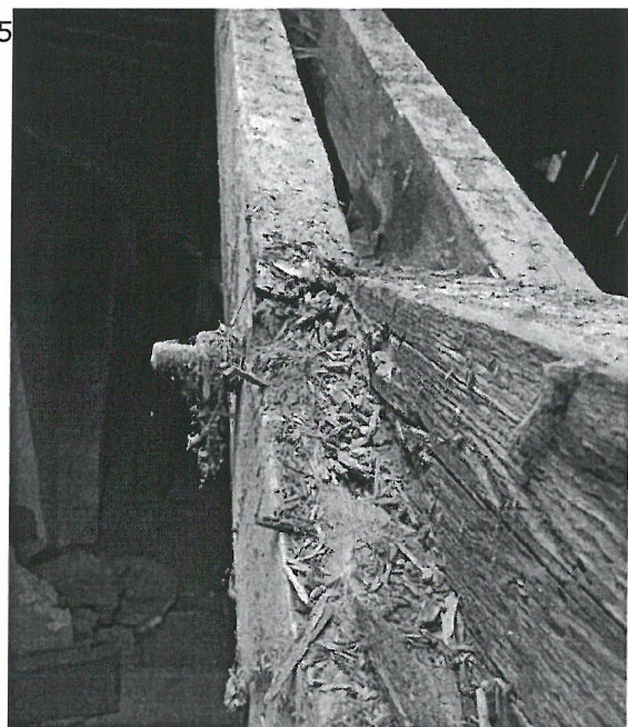
FOT.26 Korozja kleszcza w części środkowej
