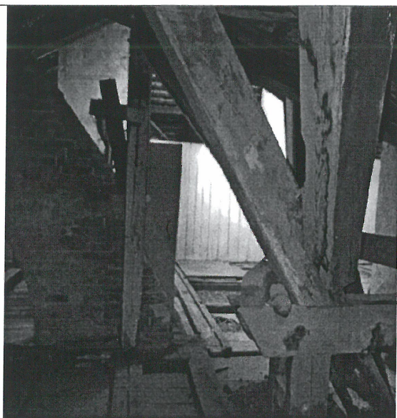
FOT.19 Korozja słupa pod koszem od strony płn.
