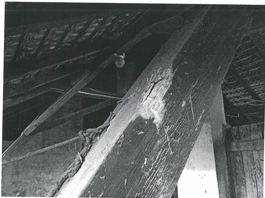
FOT.17 Korozja słupa w części środkowej
