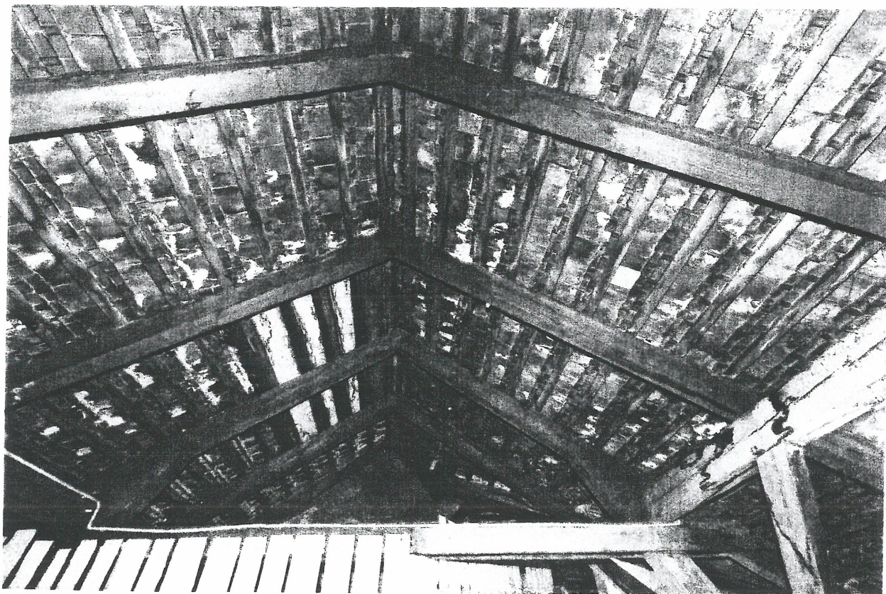
Fot. 10. Stan zachowania pokrycia dachowego.
