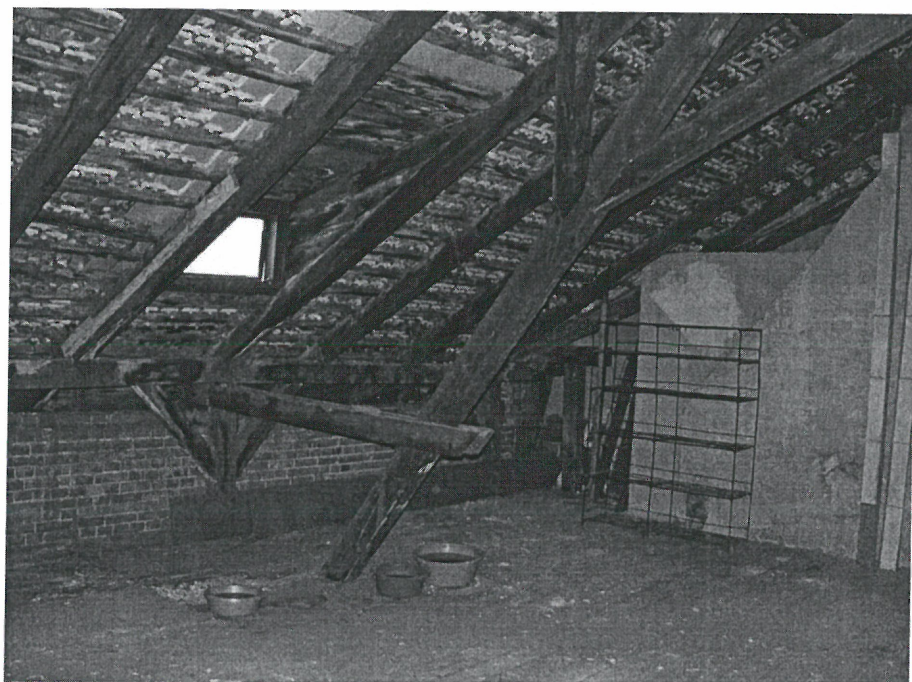
FOT.10 Uszkodzony dach w części środkowej poddasza
